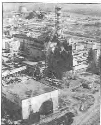
Разрушенный 4-й энергоблок Чернобыльской АЭС и строительство укрытия над ним. г. Припять Киевской области. Зима 1986–1987 гг.
