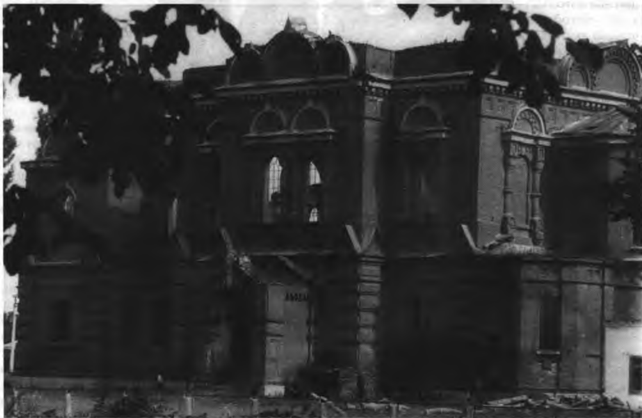
Разрушенный храм в ст. Платнировской
